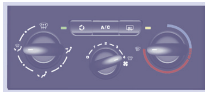
Panou aer condiționat
